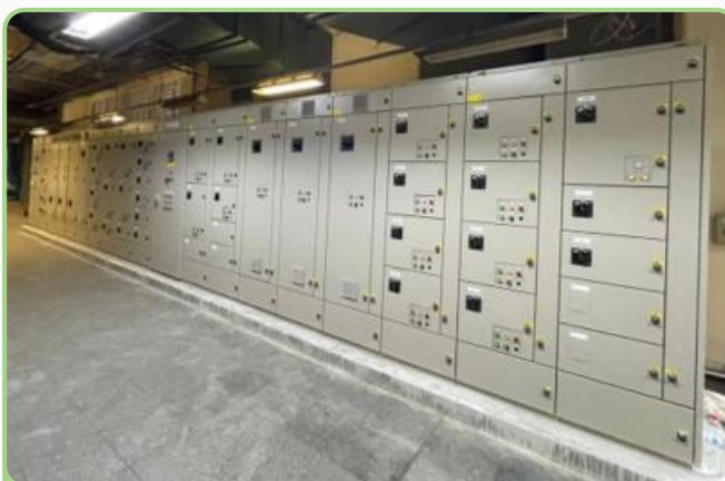
低壓閉鎖型配電盤
